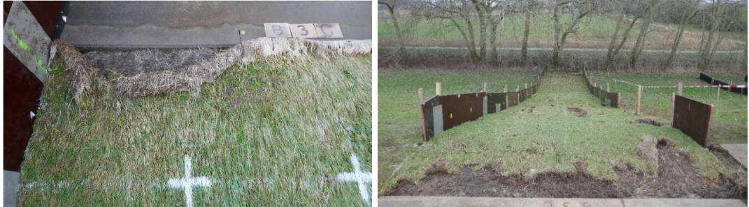
Figuur A.9 Strook 2, schade overgang betonpad naar gras na 4 uur GO5 (links) en 5 uur GO50 (rechts).
