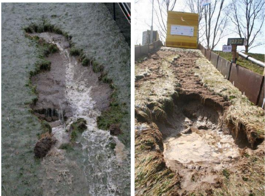
Figuur 2.3 Doorbraak toplaag; links Boonweg (kleibekleding op zandkern), rechts Overijsselse Vechtdijk (volledige zanddijk).
