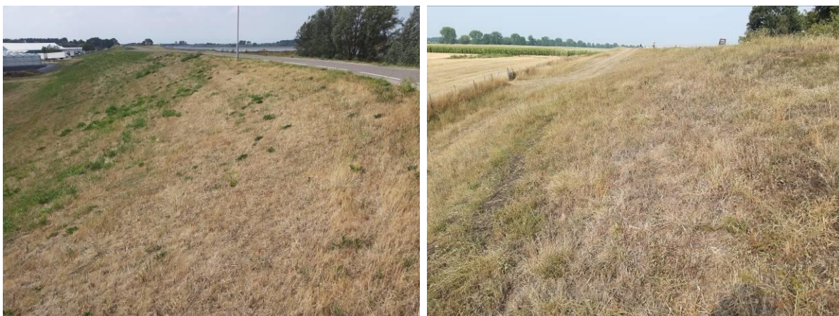
Figuur 5: Droogte; links: augustus 2018 Waaldijk Gameren, rechts: augustus 2020 Maasdijk Overasselt.
